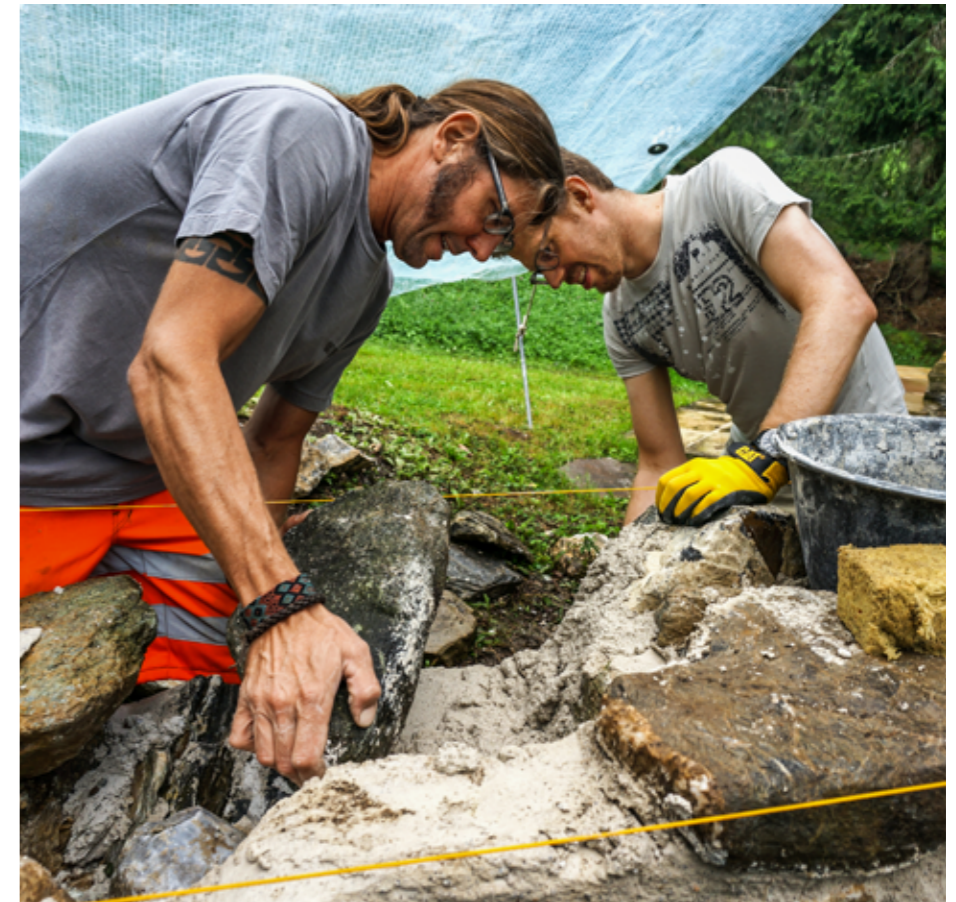
Christoph Hégéle drückt den Stein auf dem Mörtelbett in seine Idealposition. Er sollte seinen äussersten Punkt in die gewünschte Ebene geben, also etwa zwei Millimeter Abstand zur Schnur aufweisen.
