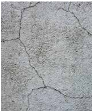
Fessurazioni stabili e piccoli avvallamenti
