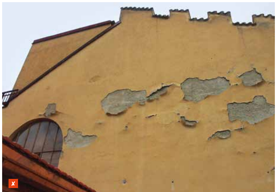
Renovierungs-Ergebnisse mit zu dichten oder zu starren Spachtelmassen
